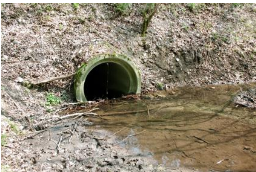
Abb. 10: Verrohrung am Bosselbach mit deutlich erkennbaren staubedingten Ablagerungen organischer und mineralischer Feinmaterialien.
